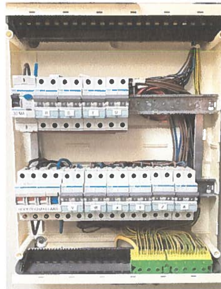
( Elektrisch bord - binnenkant )
