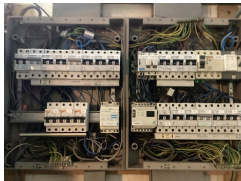
( Elektrisch bord - binnenkant )
