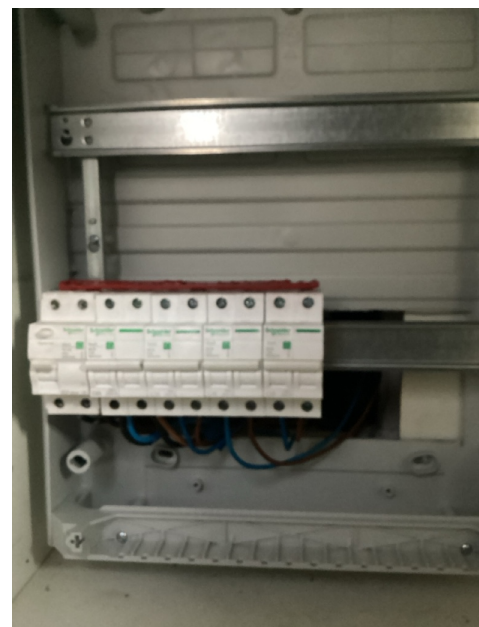
(Elektrisch bord - binnenkant)
